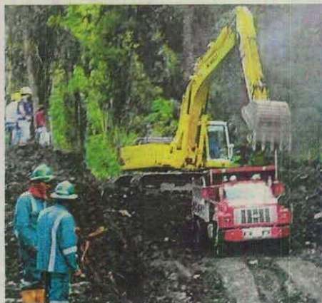
Durante los últimos 14 meses el Consorcio del Sisga ha removido unos 70 mil metros cúbicos de tierra originados por varios deslizamientos.
